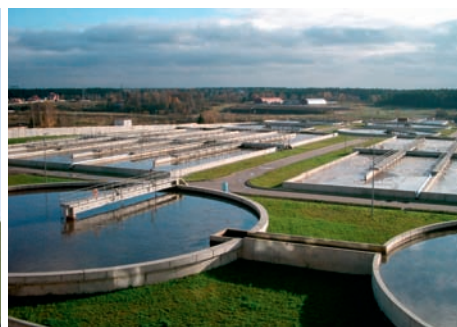
Станция очистки сточных вод Зеленоград
